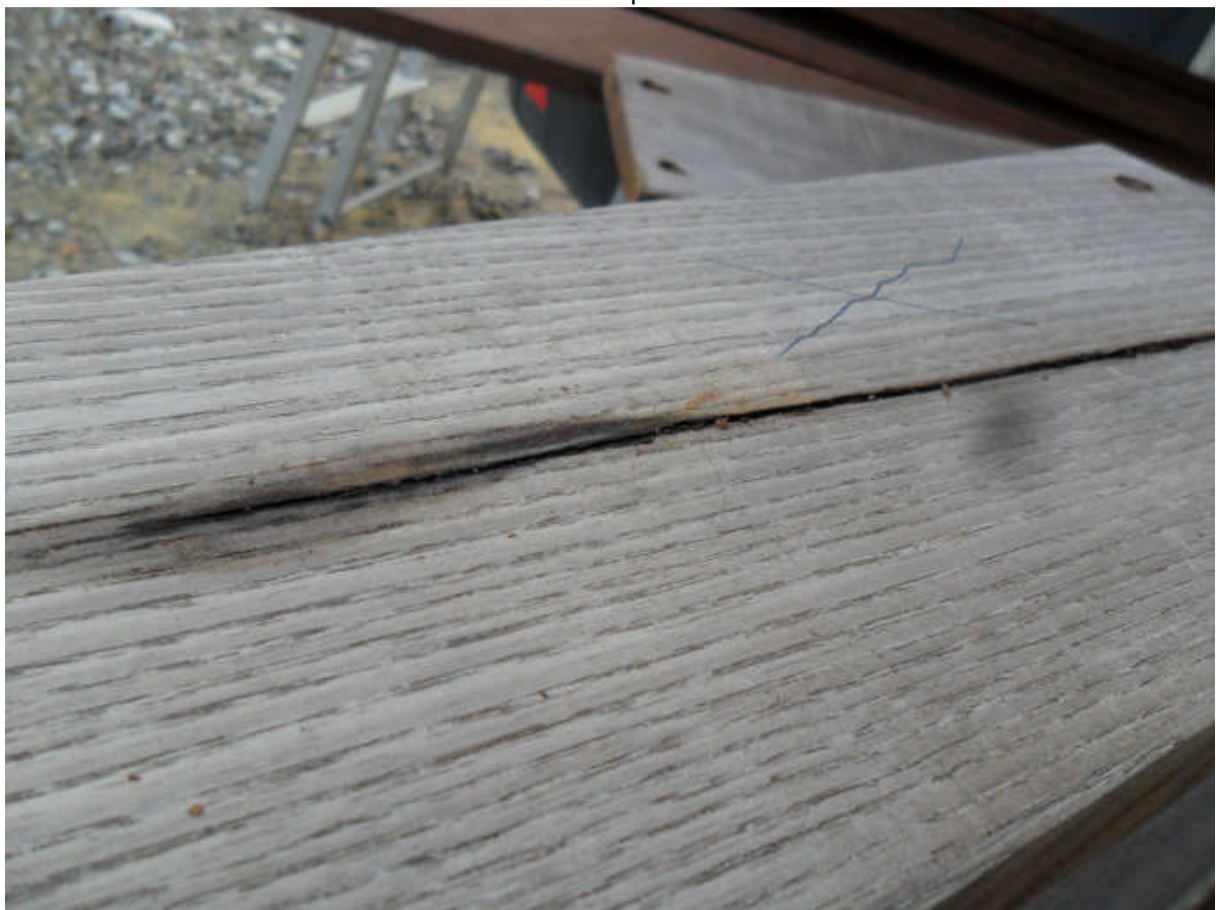
Grober Endriss ca. 30 cm lang -> das Brett muss ersetzt werden
