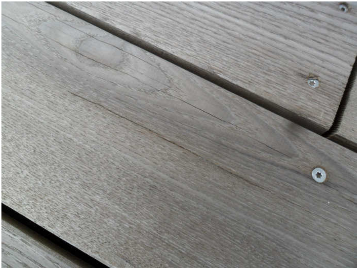
Feine Trockenrisse in der Oberfläche -> müssen akzeptiert werden
