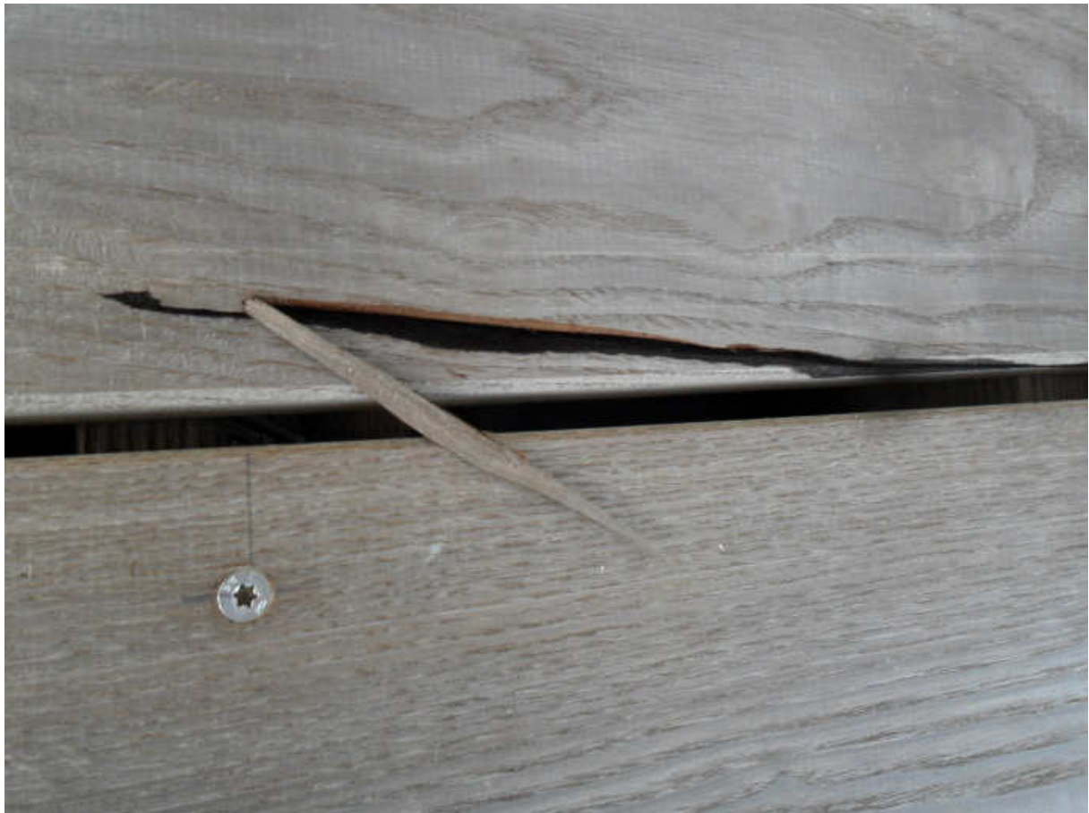
Grober Spannungsriess → das Brett muss ersetzt werden
