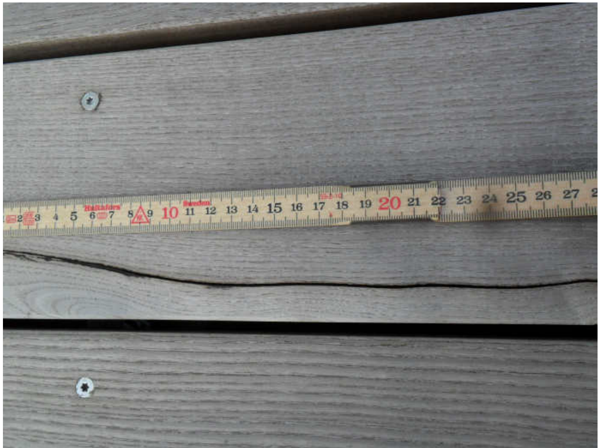
Grober Spannungsriss ca. 30 cm lang → das Brett muss ersetzt werden
